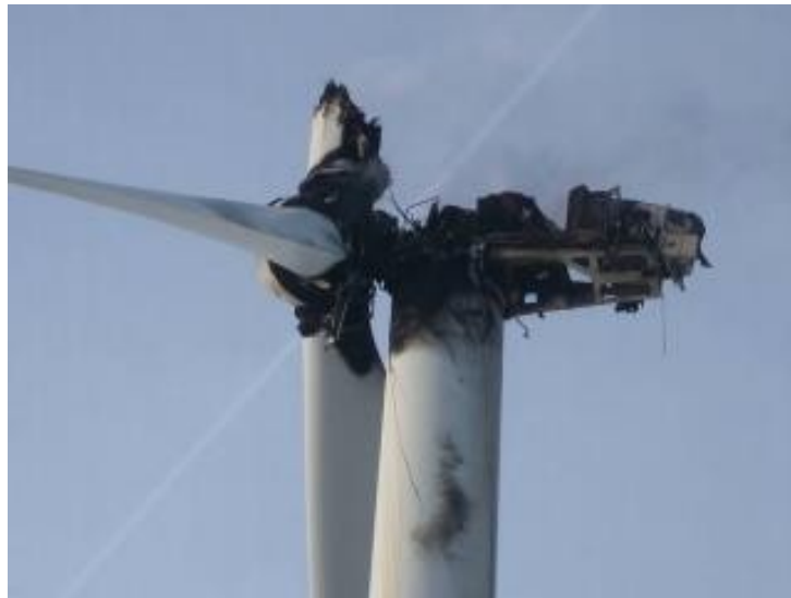
Şekil 8. 1,5 MW'lık bir rüzgar türbininin yanmış motor bölümü (Resim kaynağı: Allianz)
