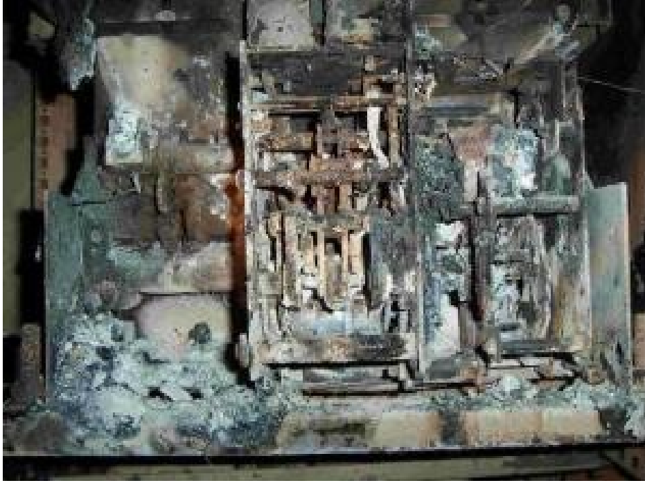
Şekil 9. 1 MW'lık bir rüzgar türbininin güç anahtarı (yangın sonunda kullanılmaz hale gelmiştir)
