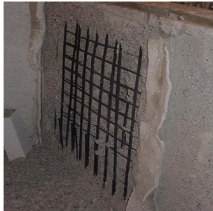
Şekil 7: Efectis Era Laboratuvarı'nda bir yangın dayanım testi sonucu oluşan spalling derinliği
